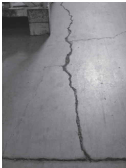
Afb. 5 Opwelling en scheurvorming van beton.
